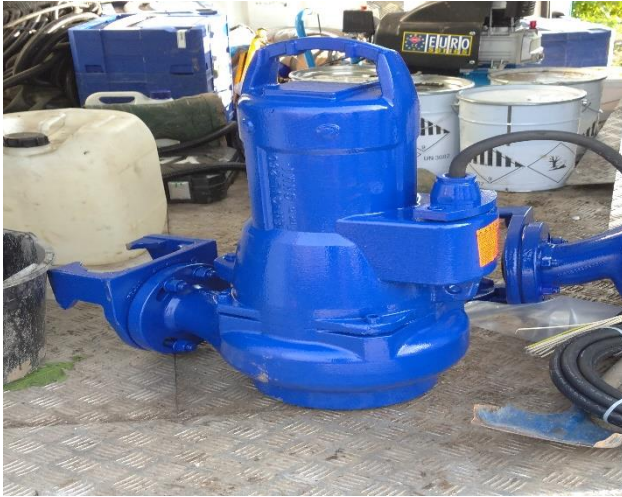
Pompa zanurzeniowa zainstalowana w jednej z pompowni ścieków.
